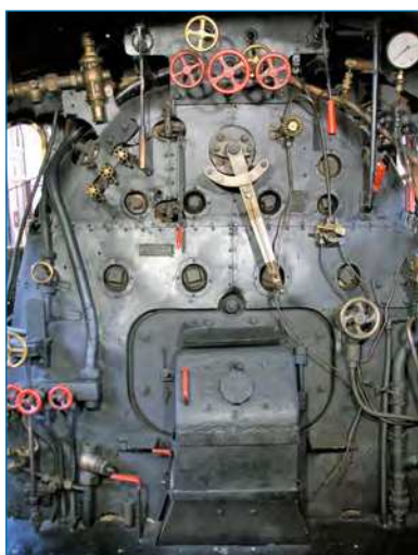
Figura 5. Frontal de la cabina (marquesina) de una Mikado. Abajo y centro se aprecia la puerta del hogar por la que en el fogonero paleaba el carbón o prendía el fuel por el "método del trapo encendido". Foto: JAMP 02/05/2018
